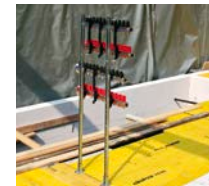
...an den Heizkreisverteiler
